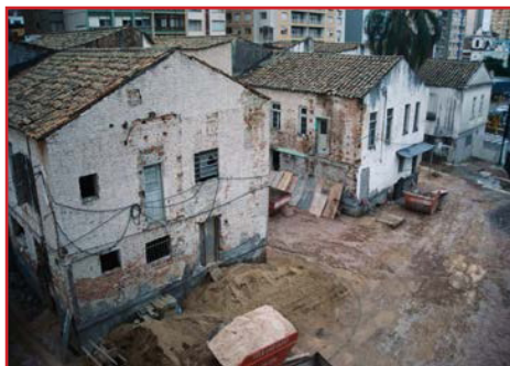
Figura 9 – Condição precária das edificações (2005)
